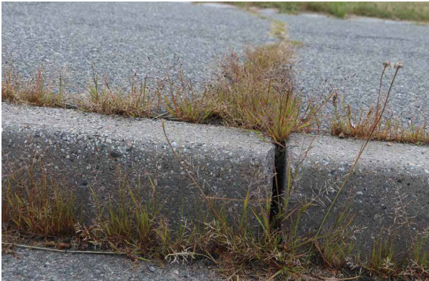
Figur 3. Mange planter af Mangestænglet Kærlighedsgræs i mellemrum mellem kantsten og asfaltbælgning på cykelsti samt i asfaltsprække. Moesbakken i Rønde. Foto: P. Wind 02-09-2025.
